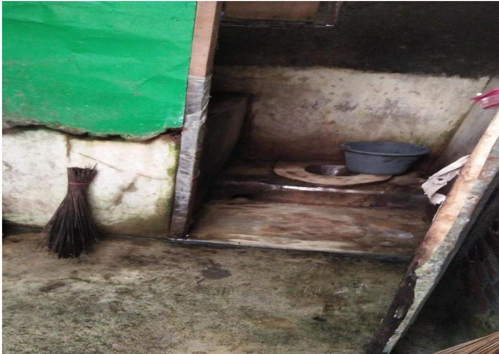
Gambar 5. Jamban rumah responden yang tidak memiliki septic tank (Dokumentasi pribadi)
