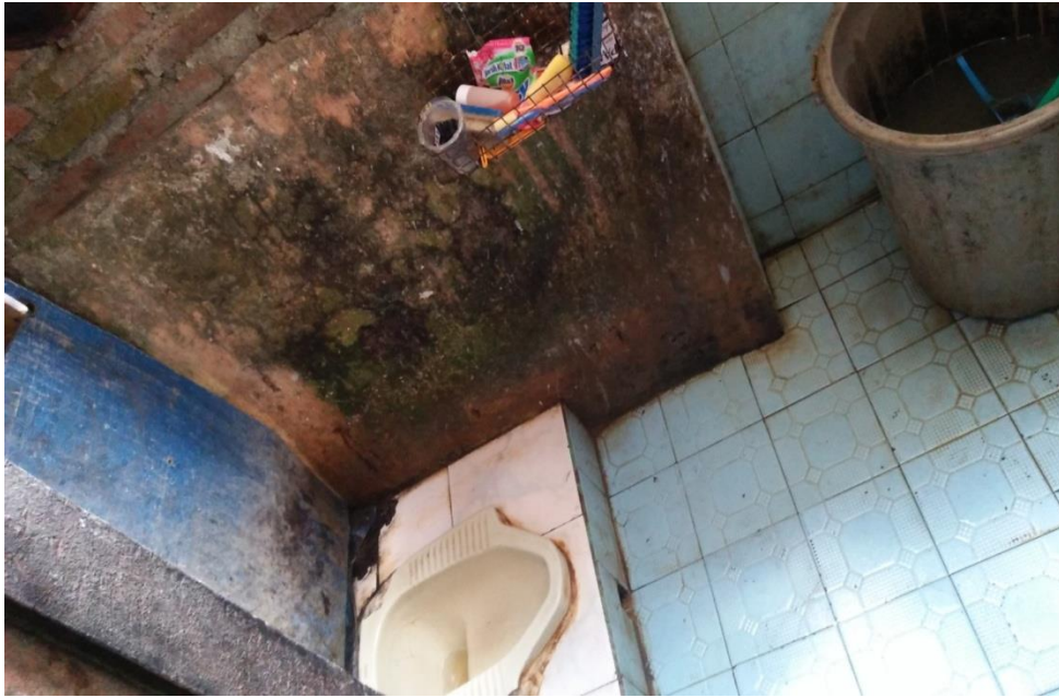
Gambar 3. Jamban jongkok yang tidak memiliki septic tank (Dokumentasi pribadi)
