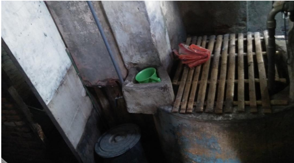
Gambar 1. Jamban rumah responden yang tidak menggunakan septic tank (Dokumentasi pribadi)
